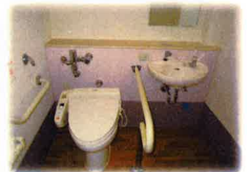
トイレ・洗面台
